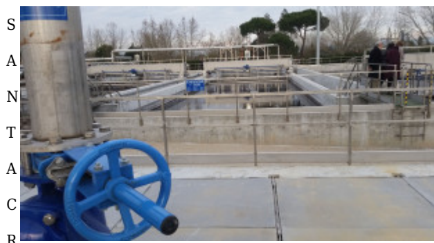
S A N T A C R OCE SULL'ARNO - VASCHE DI DEPURAZIONE
